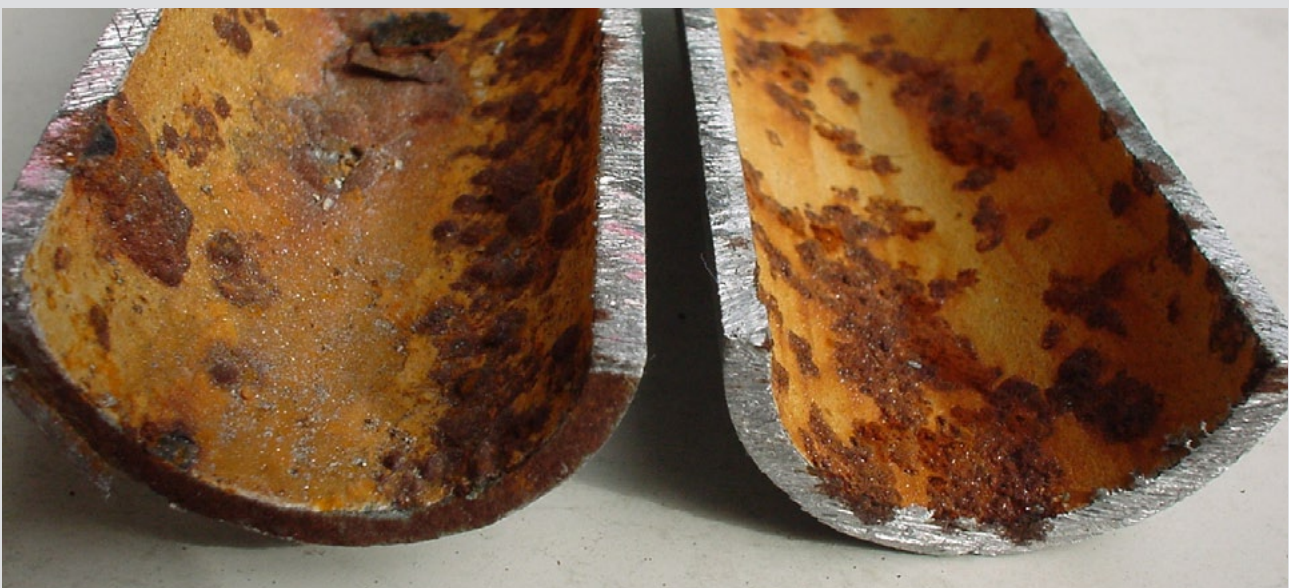
Bild: Korrosion in Heizungsrohren
